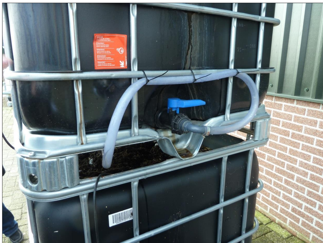
Rys. 43. Odbiór odcieków z kontenerów kolumny stanowiska BIOFILTER
